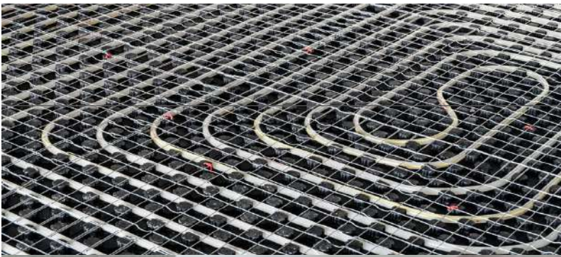
Impianto di riscaldamento
